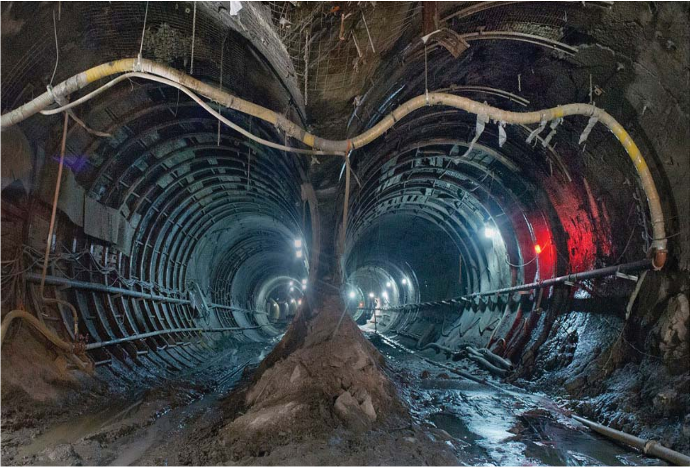
Gambar diatas menunjukkan instalasi jaringan prasarana pendukung sebelum struktur rangka terowongan di lapisi dengan lapisan beton. Pembangunan jalur kereta api bawah tanah perlu memperhitungkan jaringan prasarana pendukung tersendiri.
